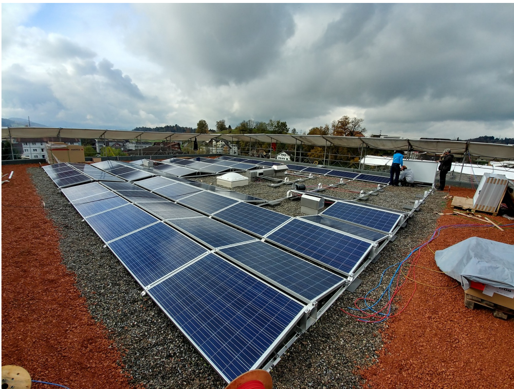
Abbildung 1: Solaranlage in Root.
